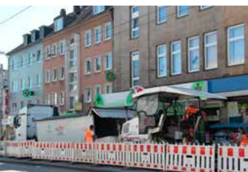
Baustelle in Essen, Altendorfer Hauptstraße Besonderheit: Auf einer Strecke von ca. 800 m, über 80 Schieber, Schächte, Hydranten sowie Oberleitungen, Einbau von LOA 5D
